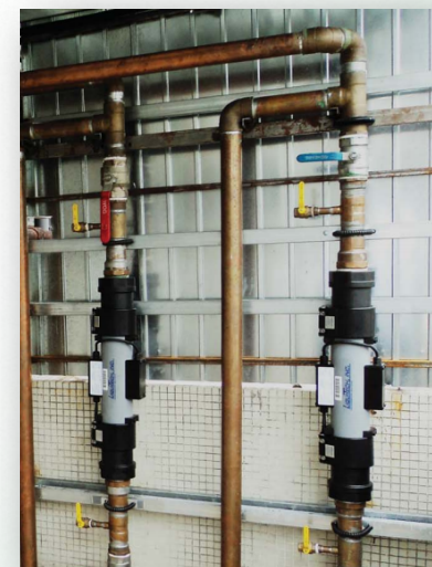
Tratamento de água por Ionização de Cobre e Prata (Central)
